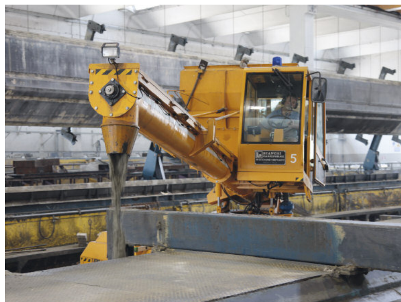
„Speedy” podczas podawania mieszanki betonowej. Jeden operator wystarcza do sterowania pojazdem i monitorowania procesu betonowania.
